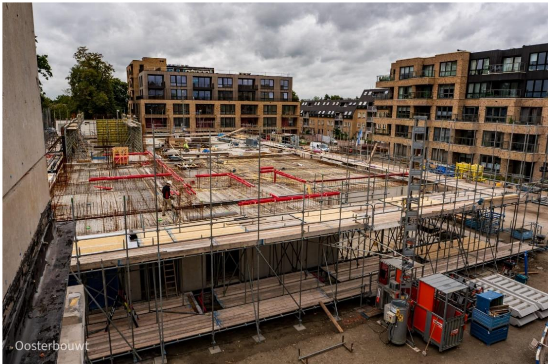
De bouw van Altera op de locatie van de voormalige westvleugel Arendshof II met op de achtergrond de twee appartementencomplexen Arendstaete (links) en Arendsplein 70 (rechts) (Foto: Oosterbouw)
